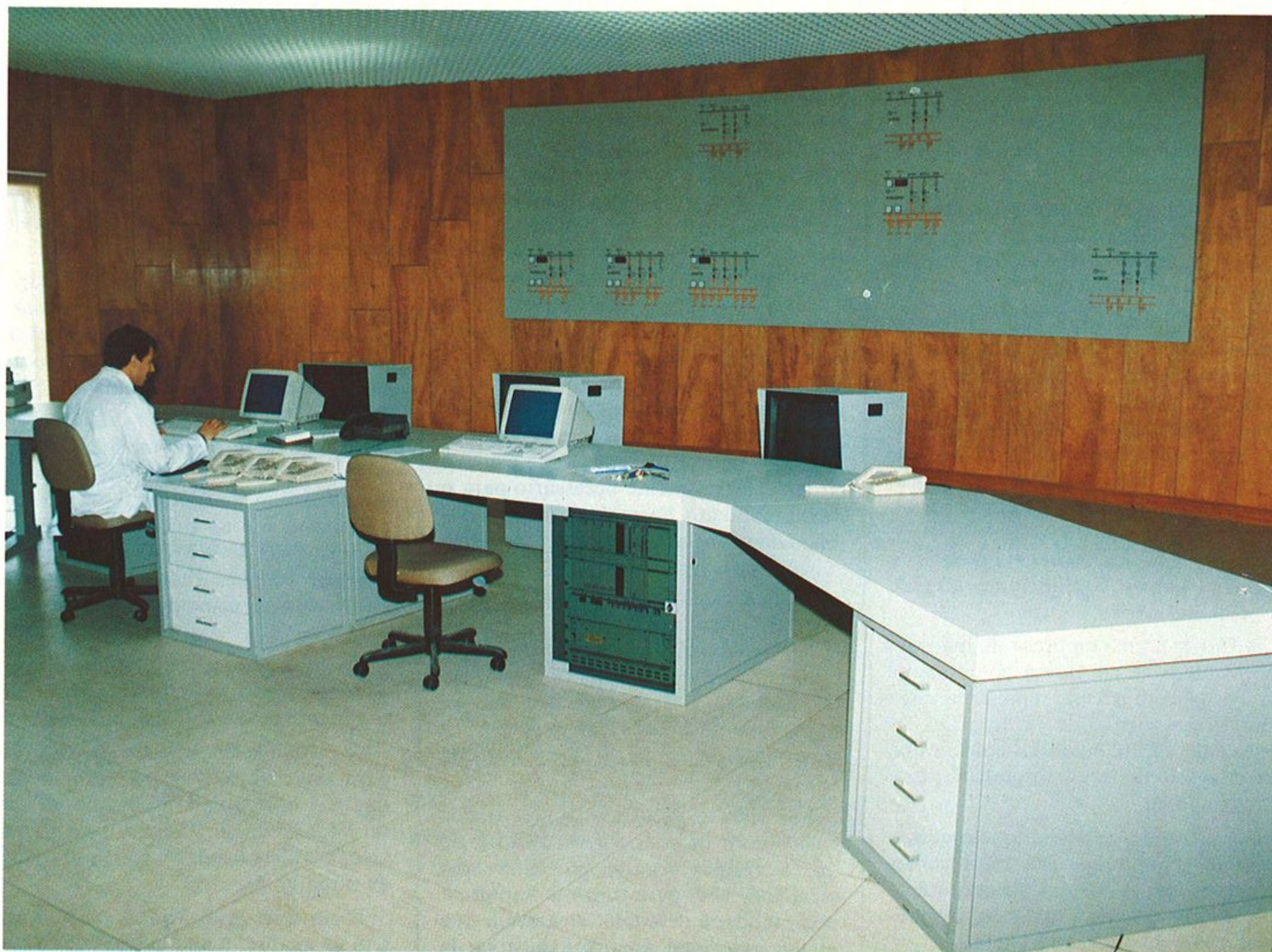
Sala de comando de energia da Carris.
