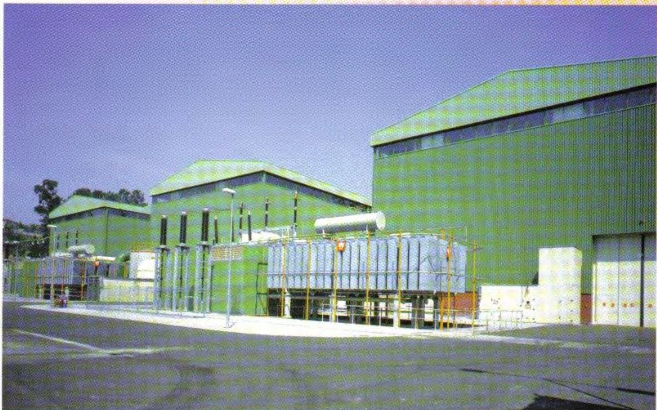
Transformadores de potência para a Central de ciclo combinado da Tapada do Outeiro
