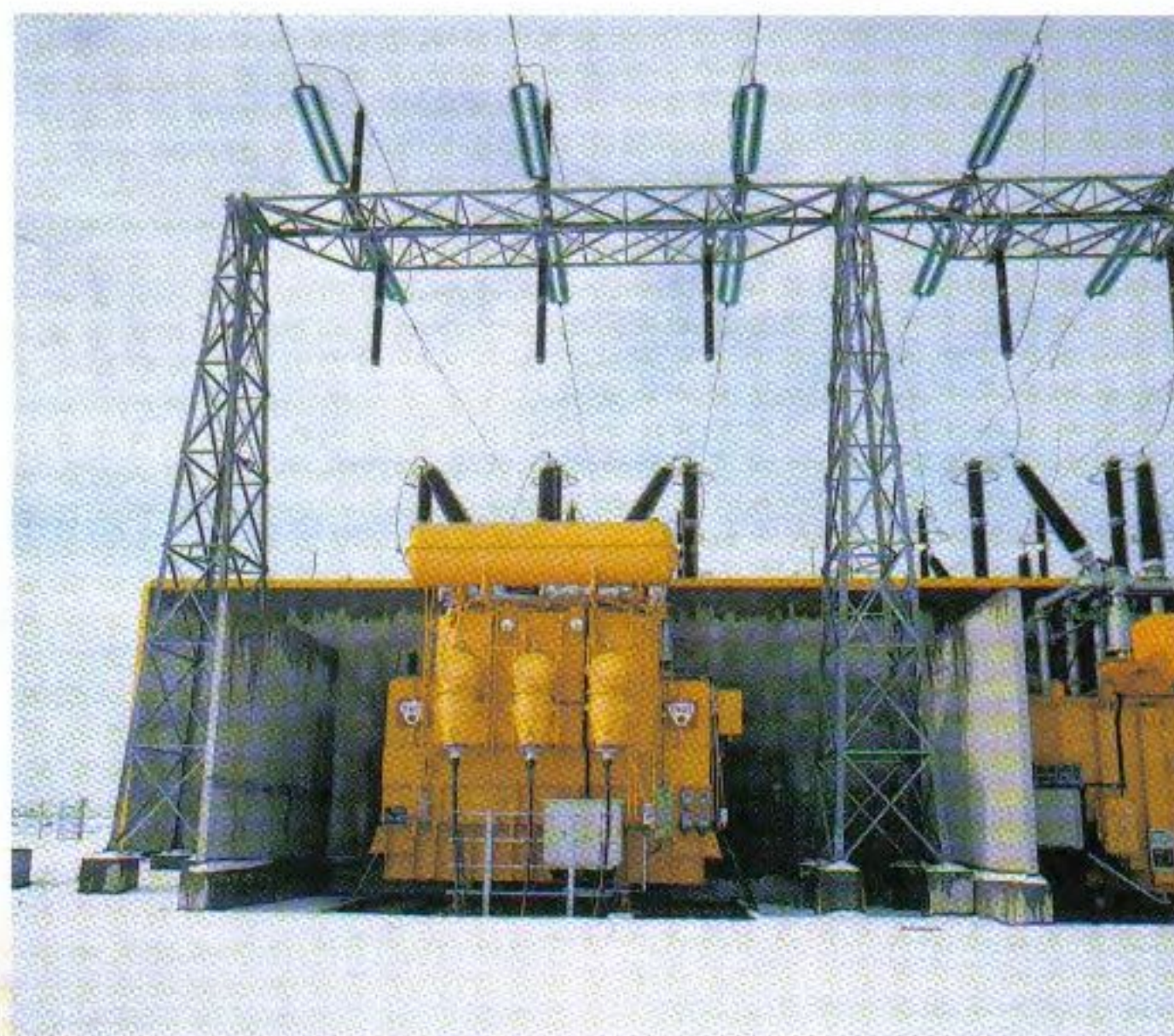
Autotransformador Trifásico 100 MVA, 220/132/11 kV - Islândia
