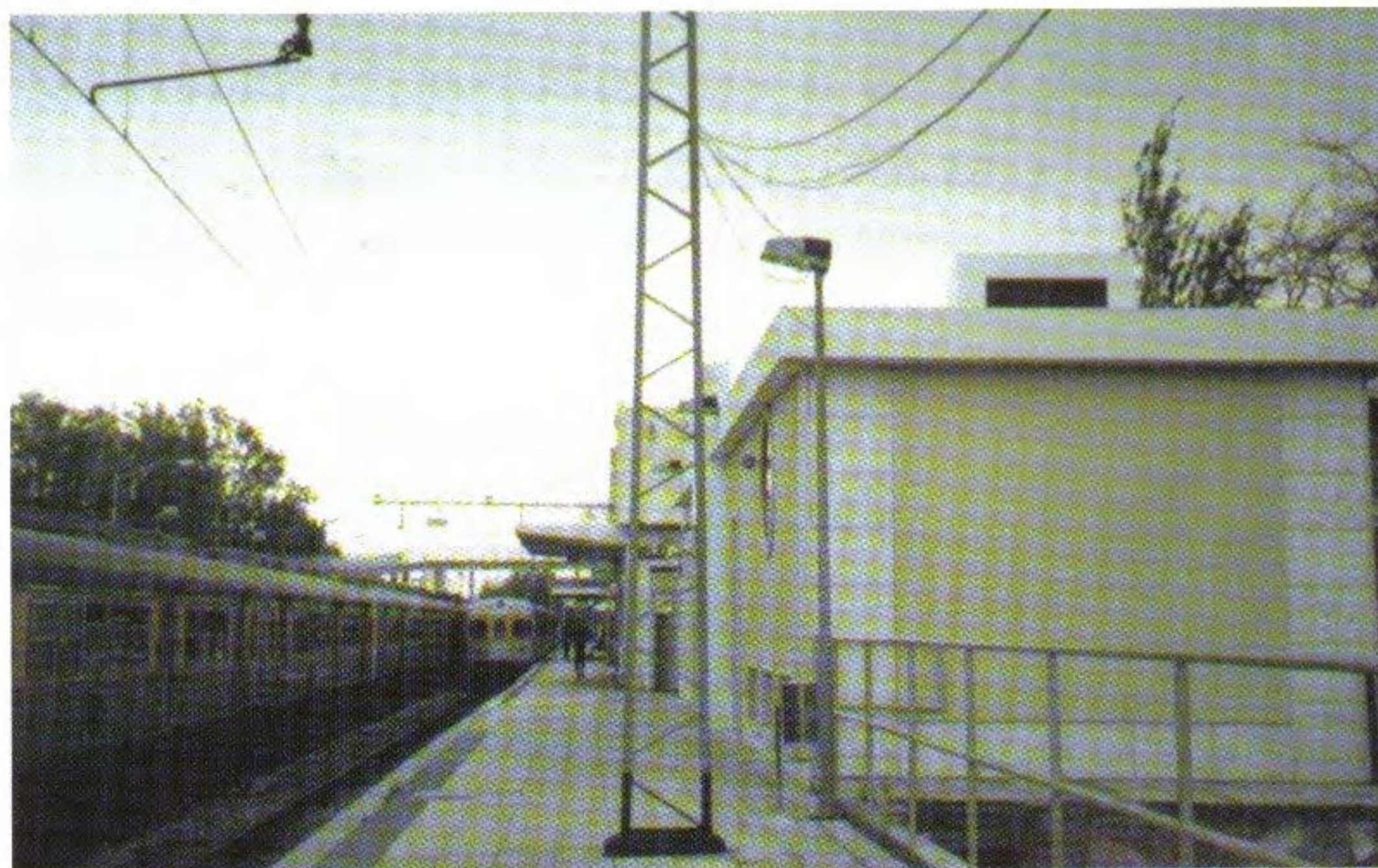
Subestação de tracção na Linha do Estoril
