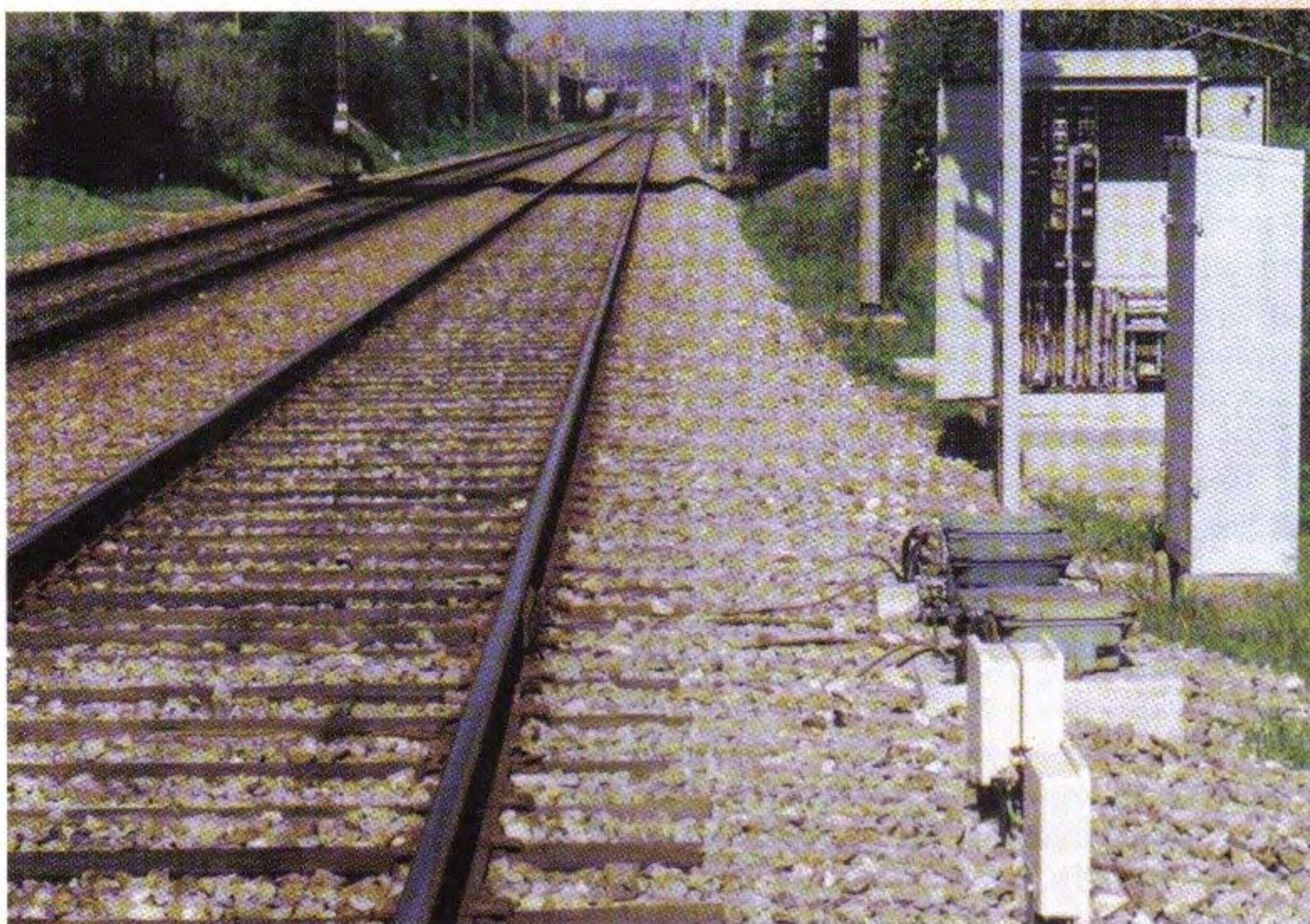
Sistema de sinalização ferroviária
