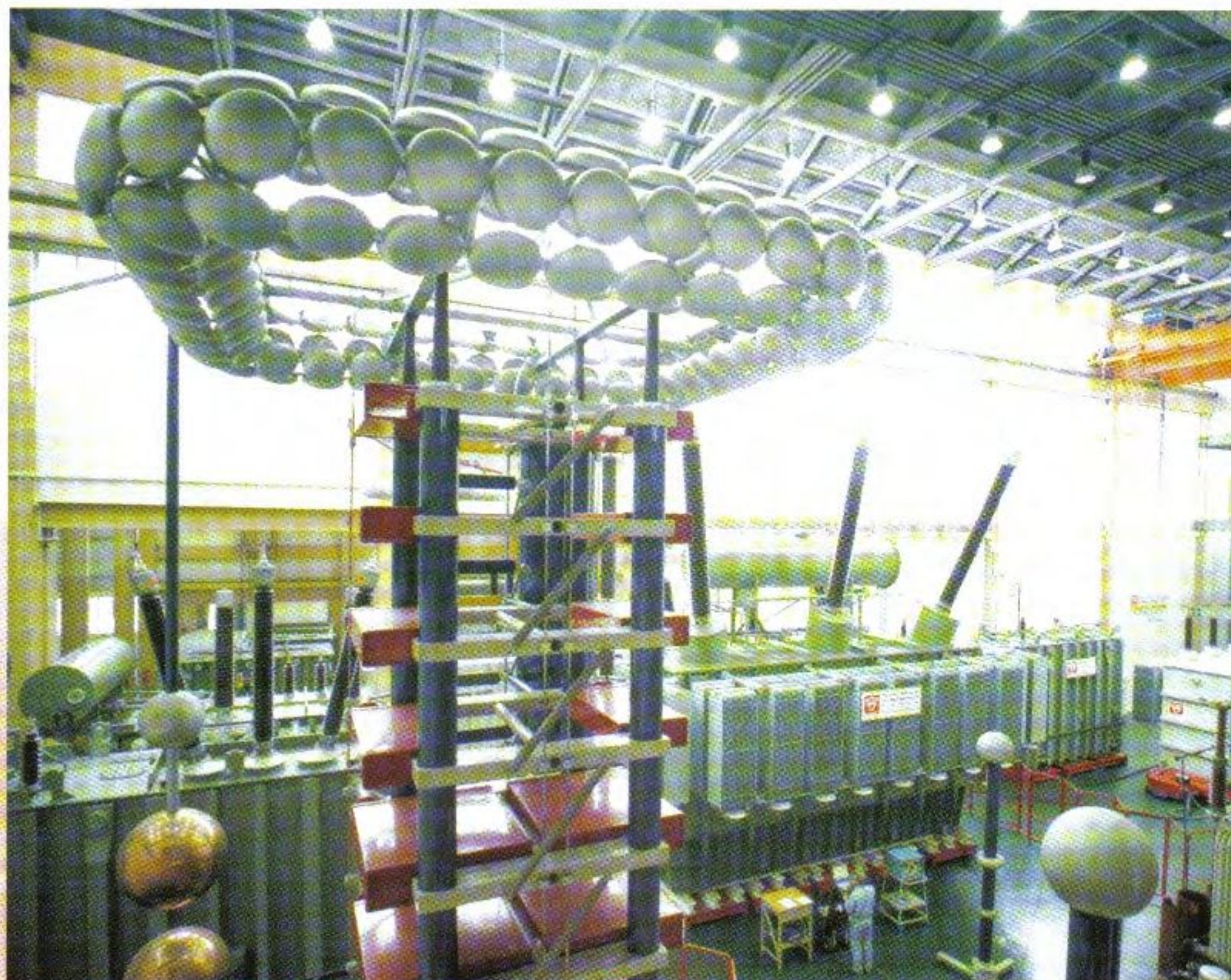
Laboratório de transformadores de grande potência
