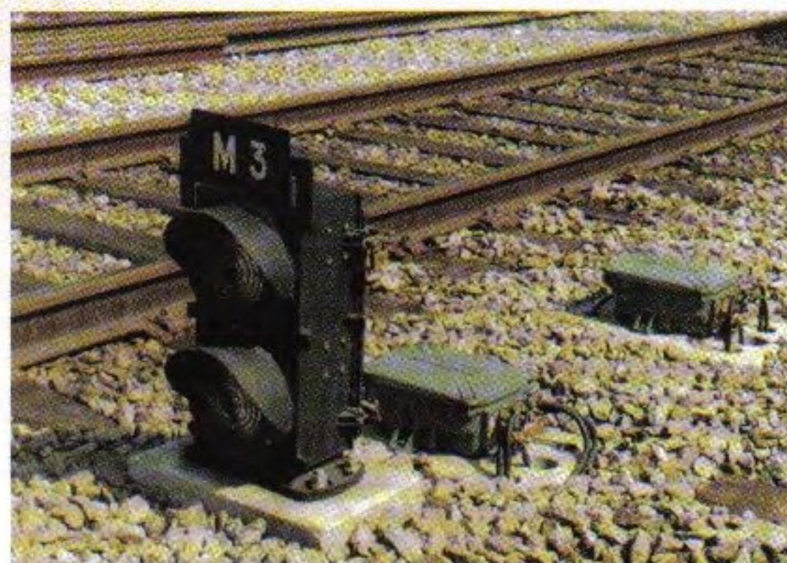
Circuitos de via
