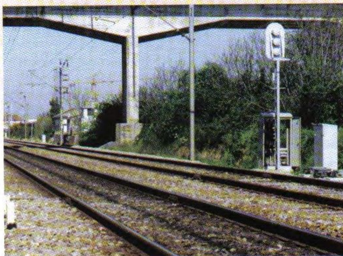
Equipamentos de sinalização de linha
