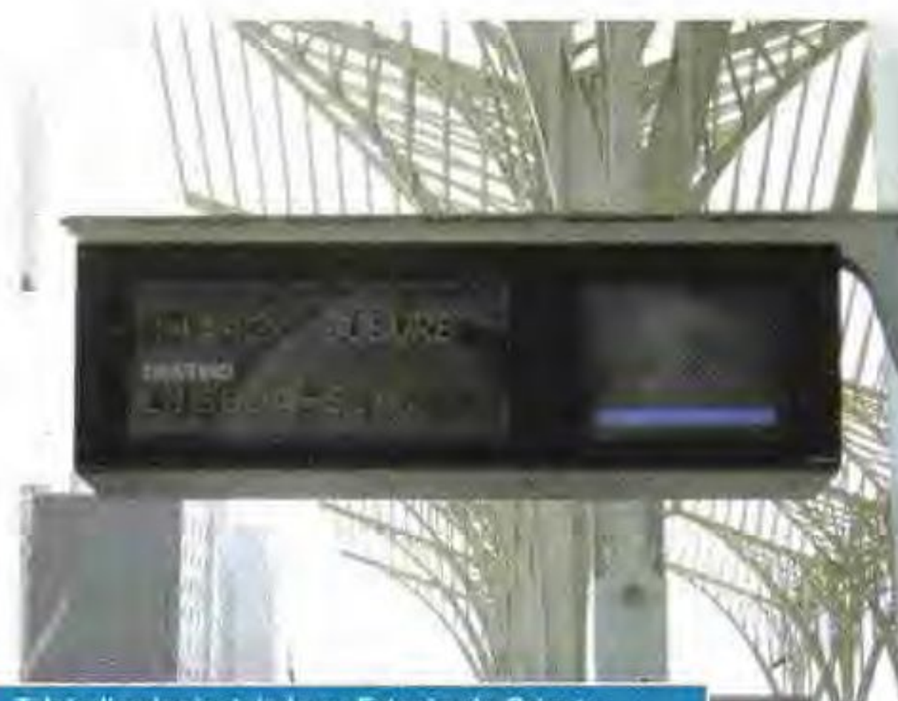
Teleindicador instalado na Estação do Oriente
