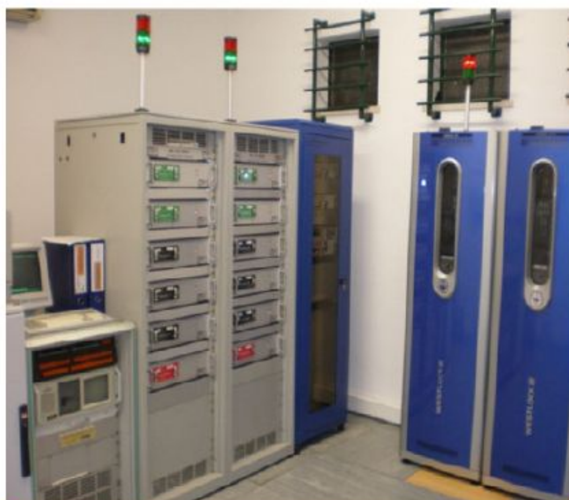
Ensaio do encravamento WESTLOCK na estação de Coruche
