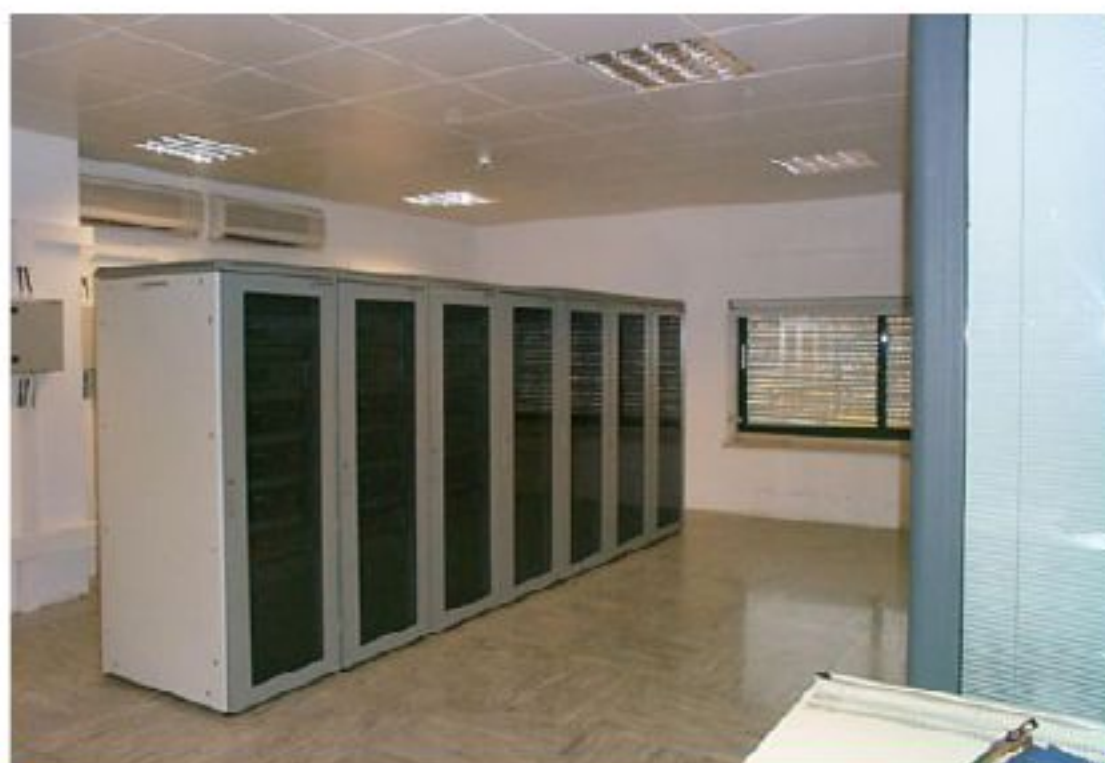
Estação de Campanhã - Sala de encravamento SSI
