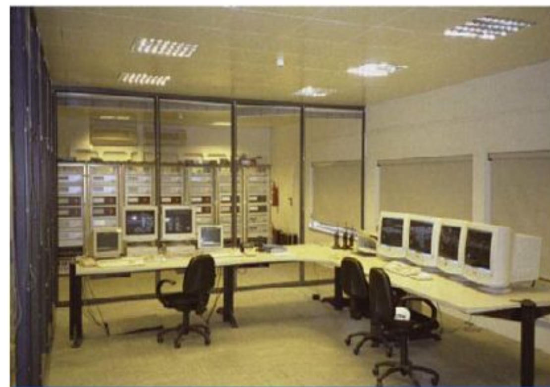
Estação de Campanhã - Salas de Comando e Encravamento
