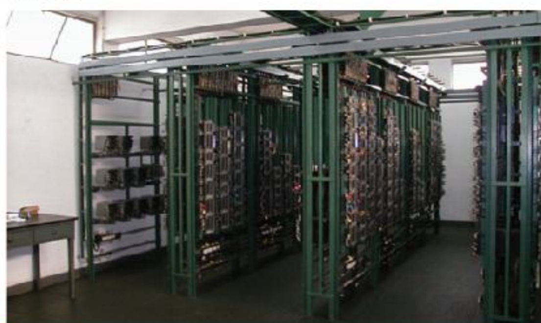
Estação de Aveiro - Sala de relês do antigo encravamento
