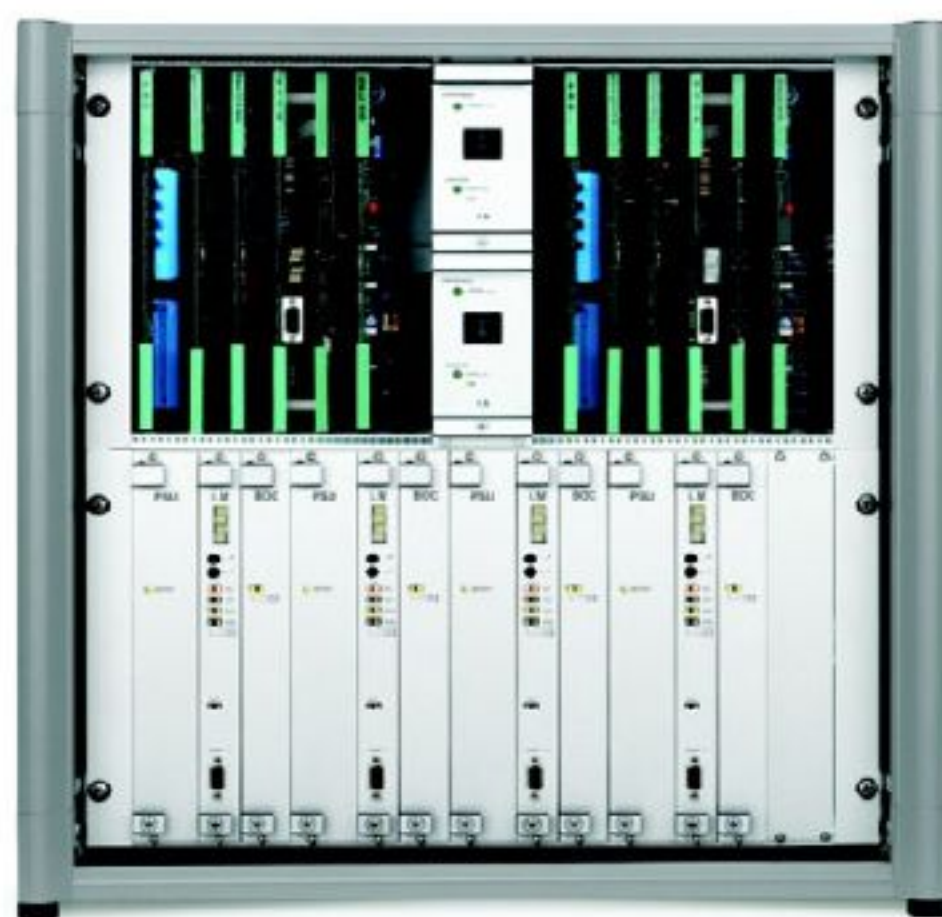
Concentrador de LEU's (Parte superior do "rack")
