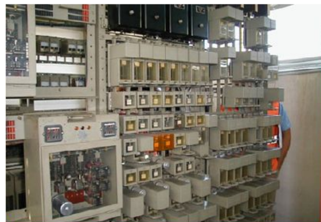
Estação de Cacia - Sala de relês do antigo encravamento
